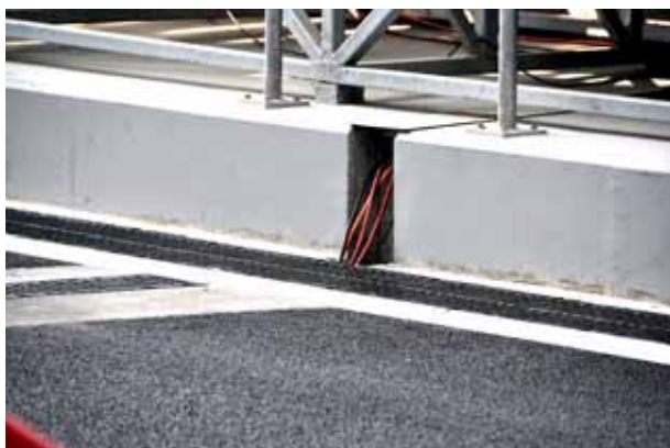
На гоночной трассе «Moscow Raceway», Московская область, Волоколамский район. Сервисные каналы ХАУРАТОН установлены на пит-лейне и вдоль пит-уолла
